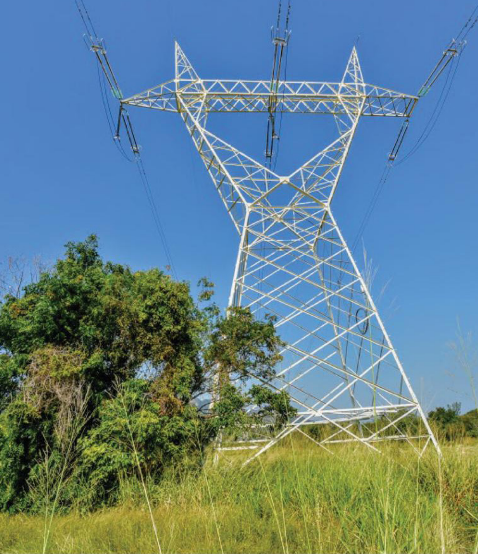
Torre de transmisión, Alto Lucero, Veracruz. Comisión Federal de Electricidad.
