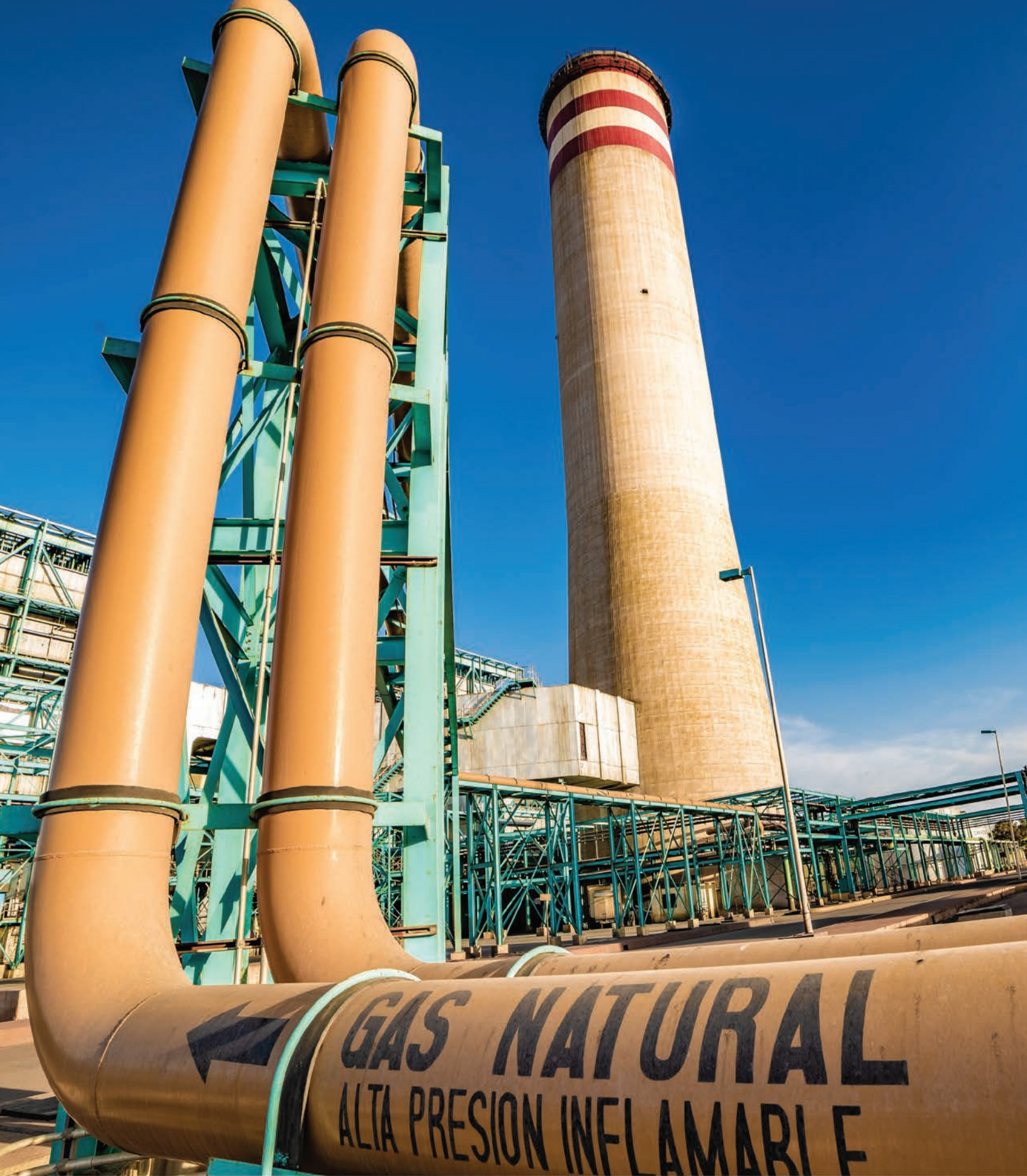
Central termoeléctrica, Villa de Reyes, San Luis Potosí. Comisión Federal de Electricidad.
